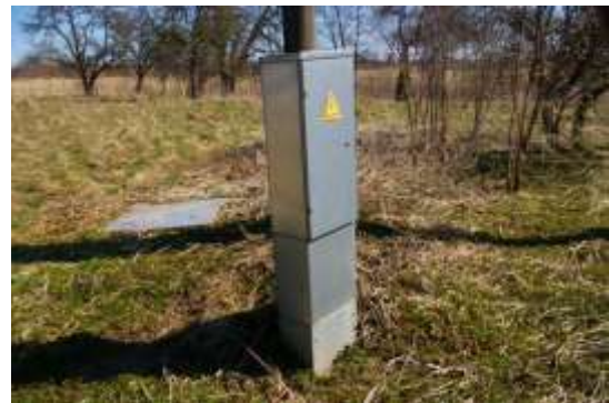
Zemes gabals ar kadastra apzīmējumu 6427 002 0367, elektrosadales un uzskaites skapis
